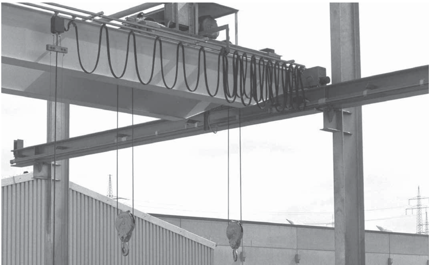
Leitungswagenanlage für Die Katzfahrt an einem Aussenkran
