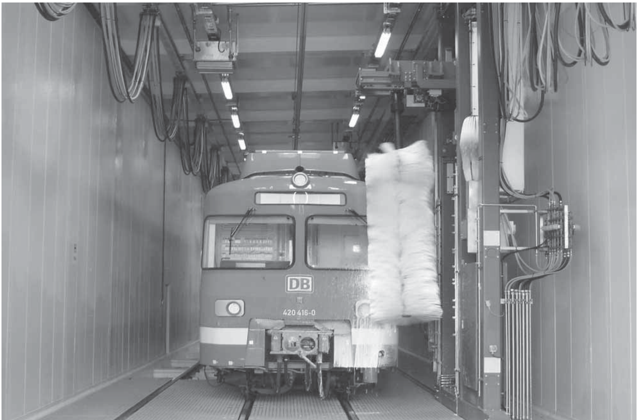
Leitungswagenanlage für eine Straßenbahnwaschanlage
