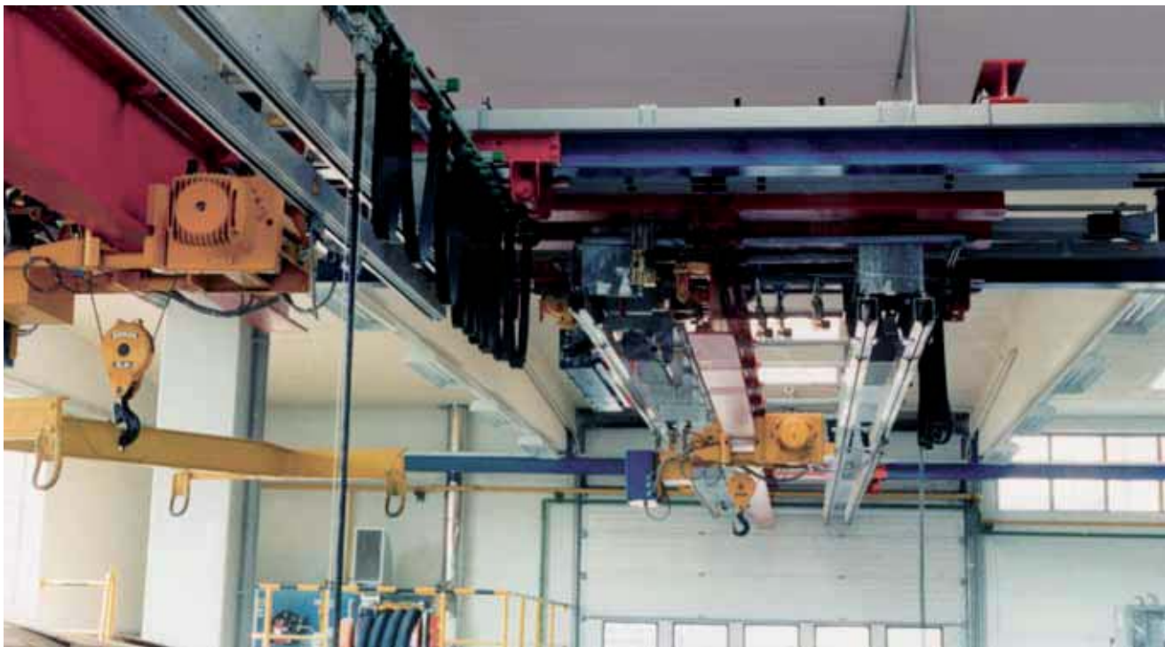
Sicherheits-Schleifleitung an einer Kranbrücke.
